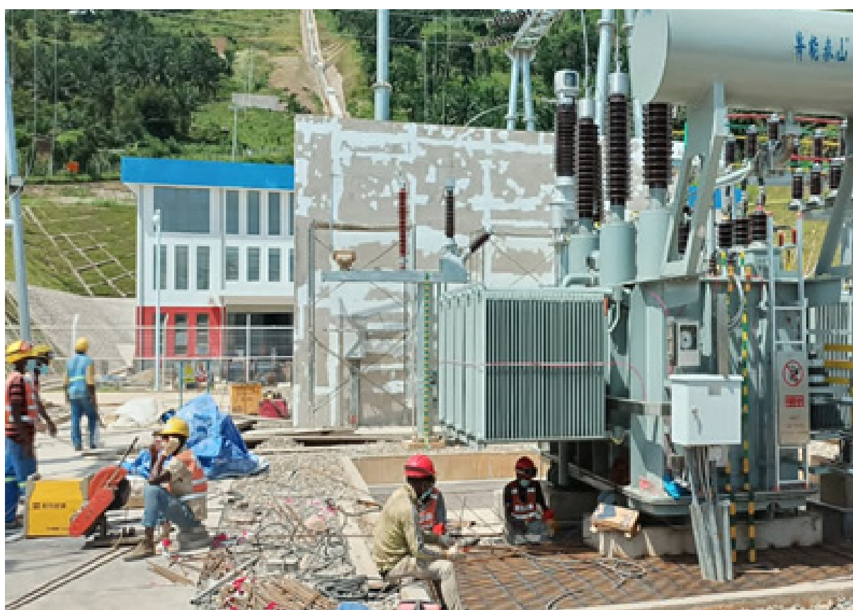
Centrale hydroélectrique de RUZIBAZI
